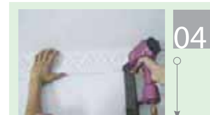
Шаг 4. Забейте гвозди с помощью пневматического пистолета, чтобы прочно закрепить карниз на поверхности
